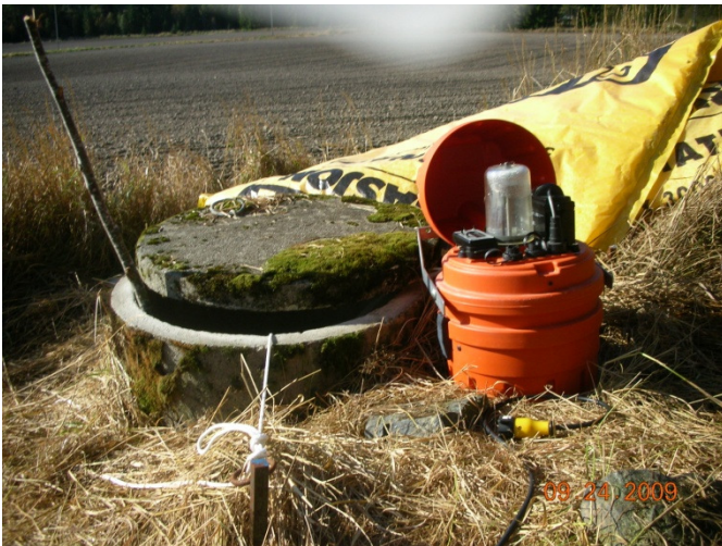
Figur 18. Automatisk prøvetaker klargjort for prøvetaking i kum etter Biovac anlegg.
