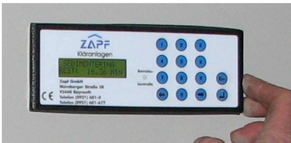
Figur 10. "Tidsvindu" for riktig uttak av stikkprøve fra Zapf-Kalro anlegg kan leses av på displayet i styreskapet.
