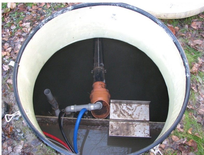
Figur 11. Zapf-Klaro anlegg sett ovenfra med utløpsrørets utgang midt i bildet.
