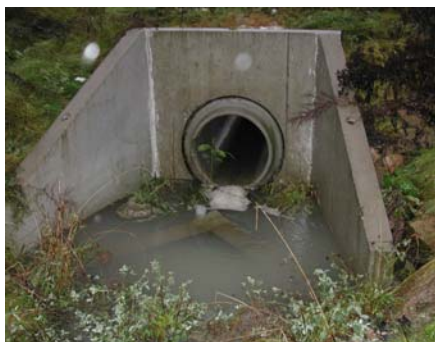
Overvann fører med seg forurensning fra tette flater til utslipp i vassdrag (Foto: Roger Roseth)
