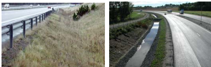
Vegetasjonskledde grøft ved motorveg i Sverige (fra publikasjon 2003:103 på http://www.vv.se/ ) og rensegrøft for overvann fra ny E6 i Råde (Foto: Roger Roseth).
